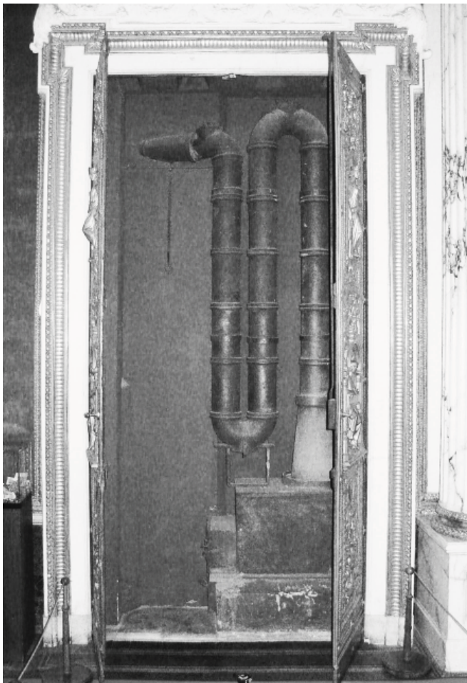
13 Rauchrohröfen im Thronsaal des Schweriner Schlosses
