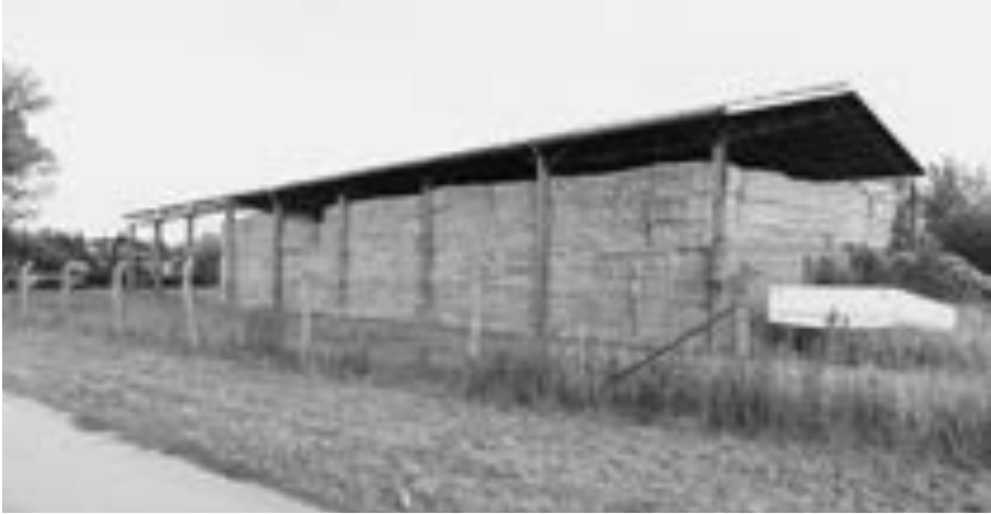
Abb. 5 Der frühe, unterspannte Parallelfachwerkbinder in Baarsdorf, Lkr. Görlitz, weist eine hohe Anzahl an Kopfstreben und Pfetten auf; das Endfeld ist aufwendig verstärkt
